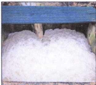
So viel Schaum im Schacht hat Kohler noch nie gesehen.
